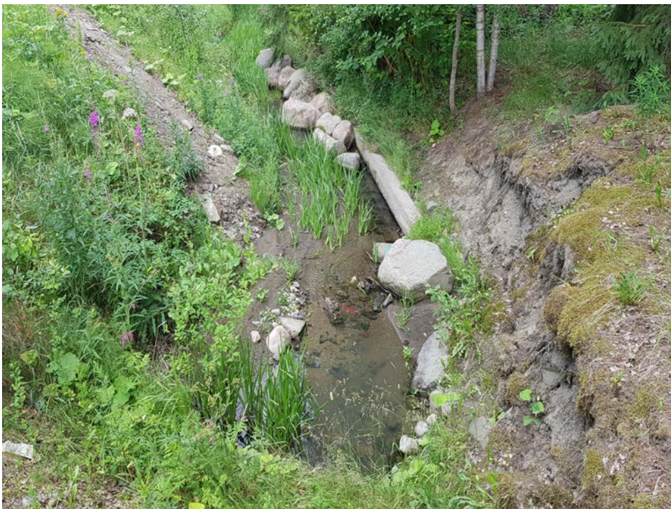
Kuva 3. Kissanoja alittaa useita teitä ja tästä syystä purossa on useita tierumpuja. Tierumpujen lähistöllä on paikoitelle kivikkoisempaa pohjaa. Uoman reunat sortuvat virtaamavaihteluiden ja yleisen eroosion seurauksena, mistä syystä puroon tulee yhä enemmän kiintoainesta.
